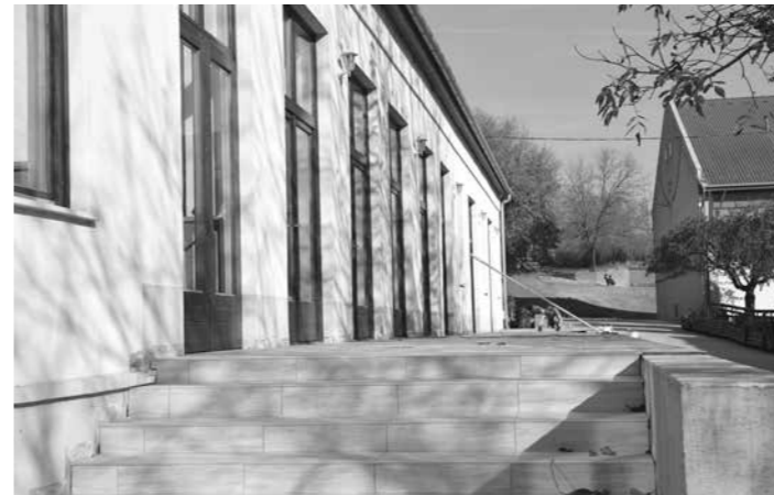
2018. őszén megtörtént a tető felújítása, teljes lécezés és a cserepek áthelyezése valamint a terasz új, kültéri, csúszásmentes burkolatot kapott. Megtörtént a nyílászárók felújítása és a nagyterembe a klíma felszerelése.
